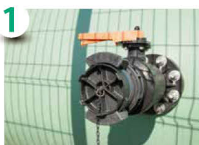
RÉSERVE D'EAU POUR LA DÉFENSE INCENDIE
