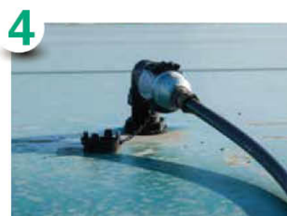
RÉCUPÉRATION D'EAUX PLUVIALES
