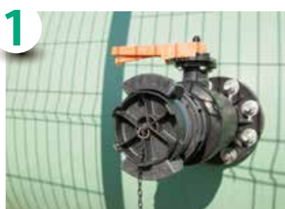
RÉSERVE D'EAU POUR LA DÉFENSE INCENDIE
